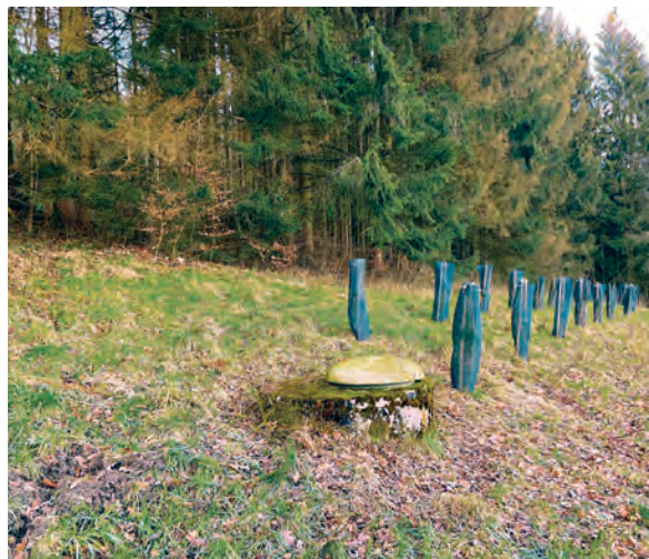
Abb. 8.2.1: Ebenerdige Brunnenstuben müssen erhöht werden
