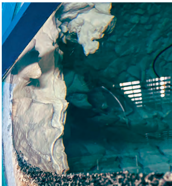
Abb. 8.3.1: Kalkausfällungen in einem Mehrschichtfilter
