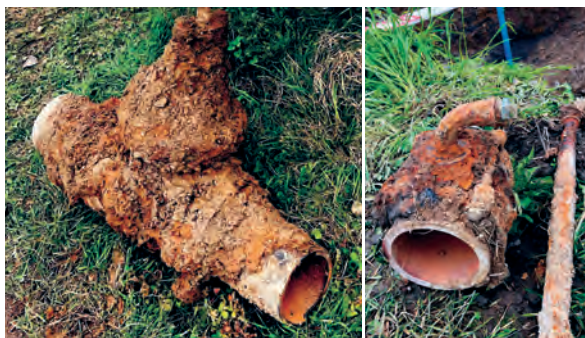
Abb. 8.2.3 und Abb. 8.2.4: Undichte Schieber und Rohre
