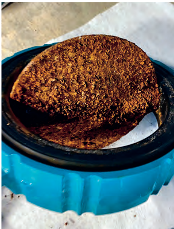
Abb. 8.3.9 Absperrklappe mit Korrosionsschäden
