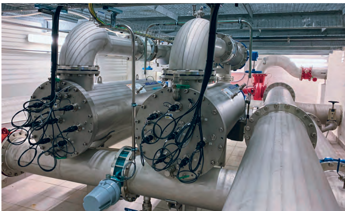
Abb. 8.2.8 Neue UV-Anlage zur Schlussdesinfektion des Trinkwassers im Seewasserwerk Tannacher
